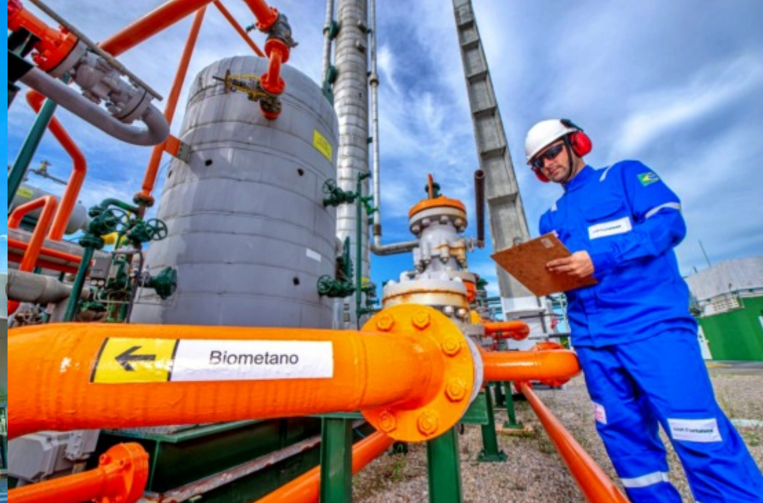
Gasodutos de distribuicao de gás canalizado na Bahia - Foto Bahiagas
