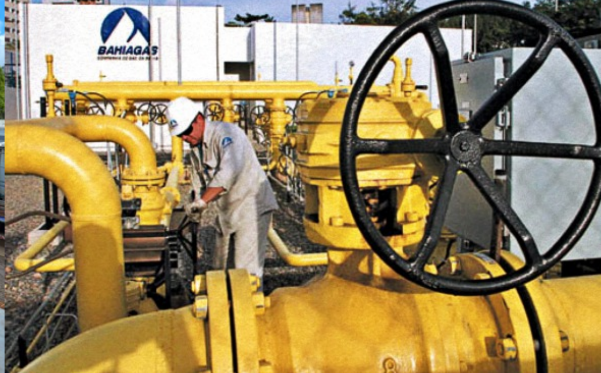
Gasodutos de distribuição de gás canalizado na Bahia Foto Bahiagás
