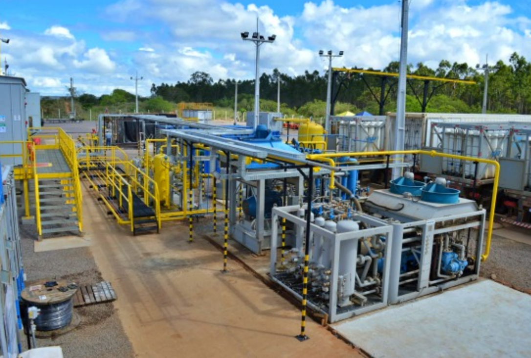
Estação de compressão e carregamento de gás natural em São Francisco do Conde (BA)
