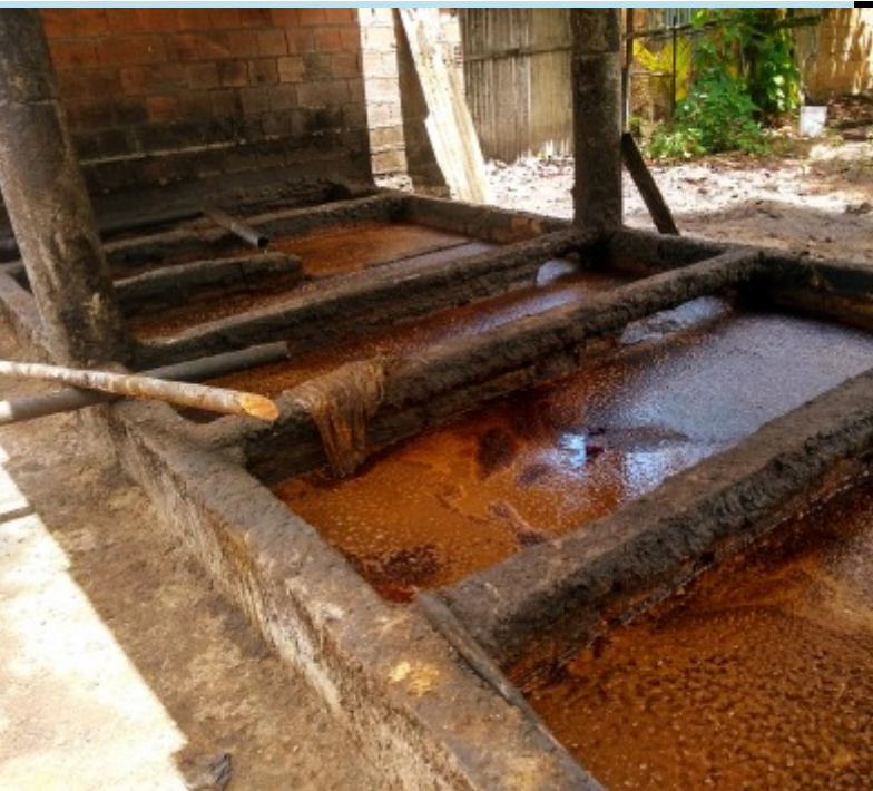
Tanques de óleo residual
