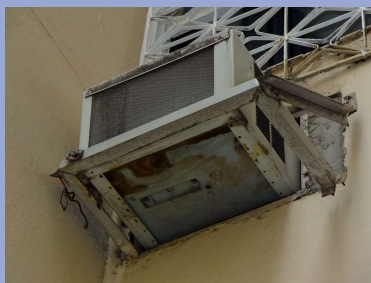
Instalação irregular de aparelho de ar condicionado
